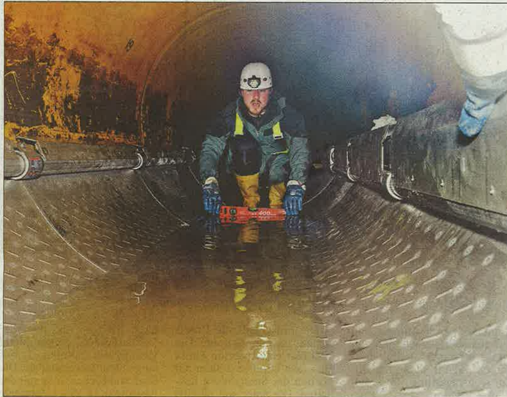
Beengte Arbeit: Christian Bechler prüft mit einer Wasserwaage den korrekten Sitz der ovalen Wärmetauscher, die im Kanal unter der Ofener Straße installiert worden sind. BILD: ARCHIV
